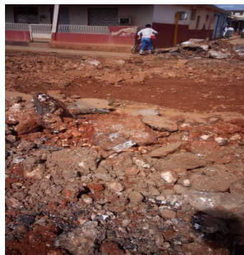
Calle cerrada. Foto: ICLEP
