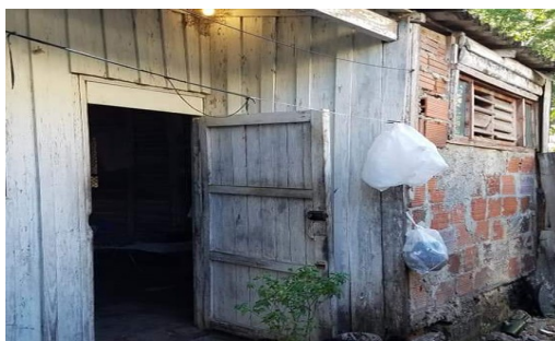
Casa en peligro de derrumbe: Foto ICLEP
