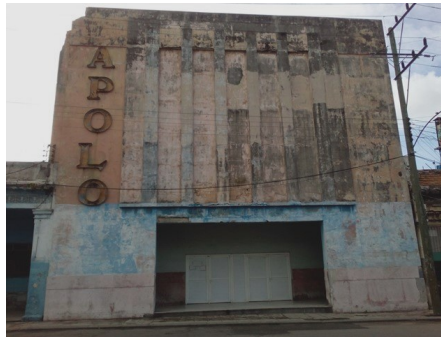
Cine Apolo deteriorado. Foto: ICLEP
