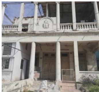
Inmueble derruido. Foto: ICLEP
