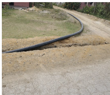
Obra detenida: Foto ICLEP
