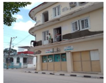
Reparaciones Foto ICLEP
