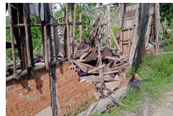
Casa de tabaco afectada: Foto ICLEP
