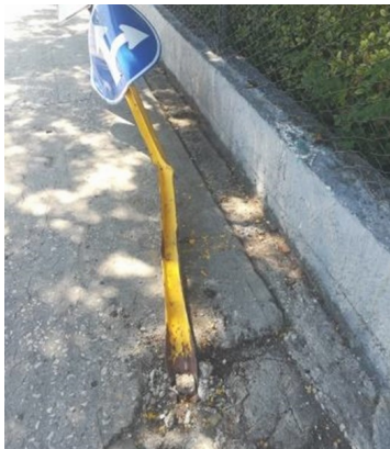
Señal de tránsito derribada en un accidente, calle Línea entre G y H, municipio Plaza. Foto: ICLEP
