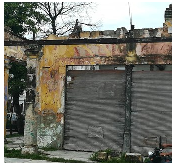
Bodega colapsada. Foto: ICLEP
