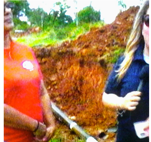
Tubería averiada, Boyeros, Foto: televisión
