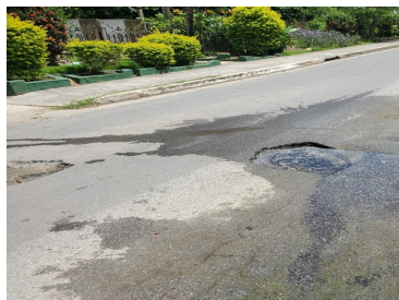
Salidero de agua en la calle E: Foto ICLEP
