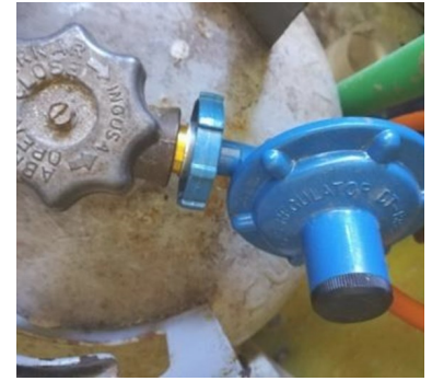
Regulador de gas, dispositivo que con frecuencia tiene desperfectos como salideros. Foto: ICLEP
