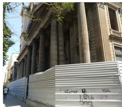
El futuro hotel Gran Hacienda, en la esquina de las calles Obispo y Cuba . Foto: ICLEP
