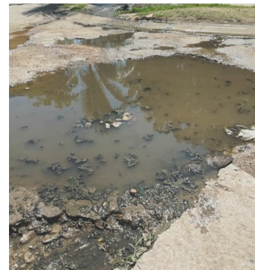
Fosa vertiendo aguas albañales en la calle 160 C entre 5ta. y 7ma., reparto Alamar, municipio Habana del Este.
