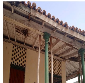
Techo de la placita del reparto Adela Azcuy : Foto ICLEP
