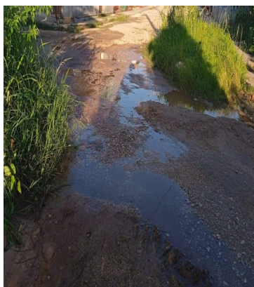
Salidero en la conductora de agua potable. Foto: ICLEP
