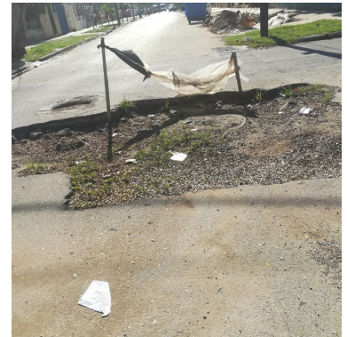
Hueco en la intersección de las calles 5ta. y E, municipio Plaza de la Revolución. Foto: ICLEP
