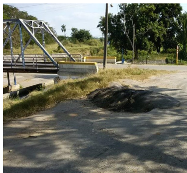
Bache en la avenida 77. Foto: ICLEP
