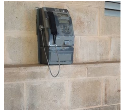
Teléfono roto, Sala de Cuidados Intensivos. Foto: ICLEP
