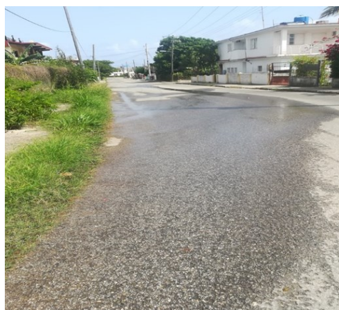
Salidero en la calle Concha. Foto: ICLEP
