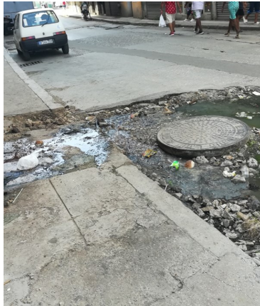
Derrame, Calle Zanja. Foto: ICLEP
