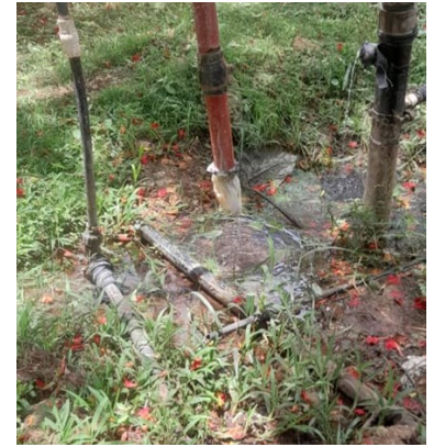
Salidero de agua al costado del Hospital Provincial Ciro Redondo.
