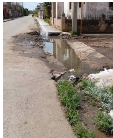
Fosa vertiendo a la calle 56. Foto: ICLEP
