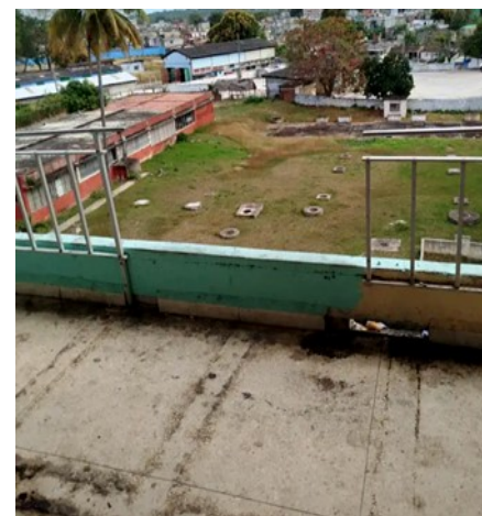
Balcón sin barandas. Foto ICLEP
