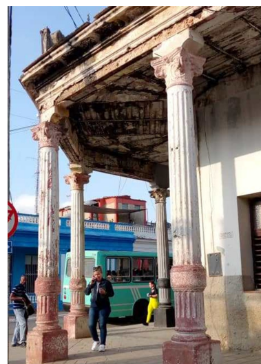
Edificación en mal estado. Ciudad de Artemisa. Foto: ICLEP
