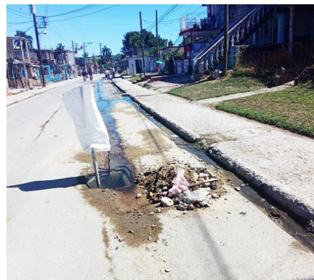
Hueco en la calle Céspedes Foto ICLEP
