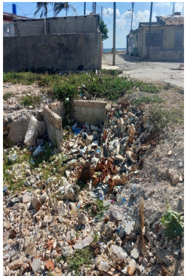
Salida del desagüe de la calle Primera y 234, Jaimanitas. Foto: ICLEP
