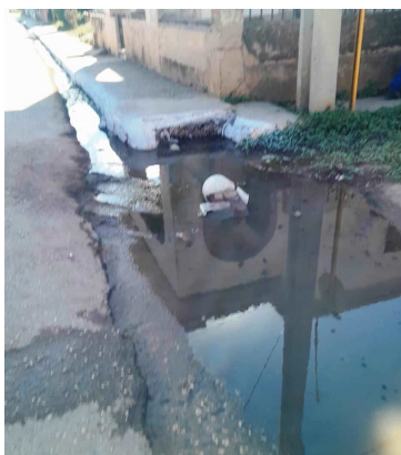
Registro de alcantarilla tupidada en la calle Céspedes, municipio Artemisa. Foto: ICLEP
