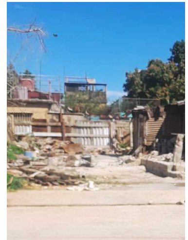
Vivienda demolida en la calle 56 esquina a 29, municipio Artemisa. Foto: ICLEP
