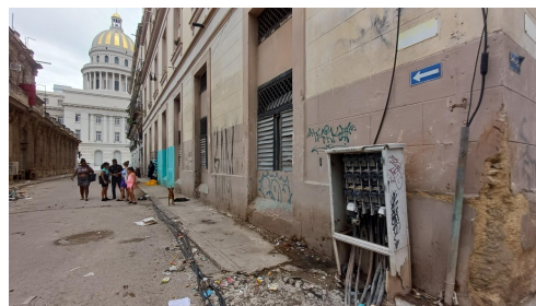
Caja de fusibles expuesta en la esquina de Amistad y Barcelona. Foto: ICLEP.
