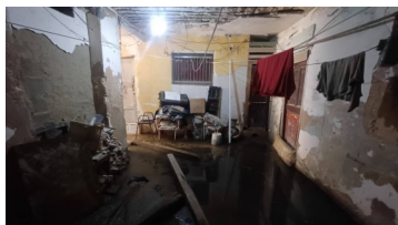
Interior del sótano, inundado en aguas albañales. Foto: ICLEP
