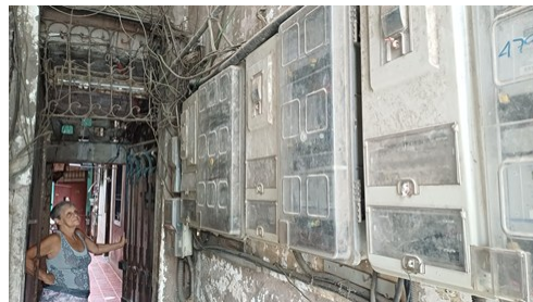
Cableado a la entrada del número 363 de la calle Amistad, Centro Habana. Foto: ICLEP.
