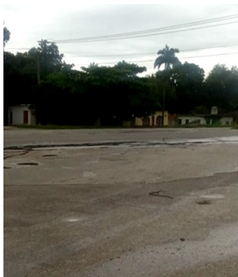
Cruce de vía peligroso. Foto ICLEP
