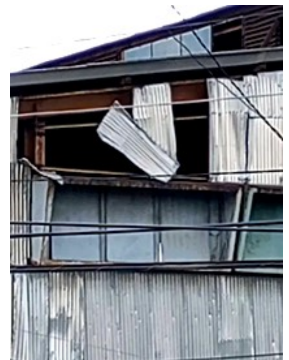
Planchas de zinc sueltas en la sala Yara. Foto ICLEP
