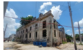
Inmueble derruido en Infanta, esquina Sitios. Foto: ICLEP
