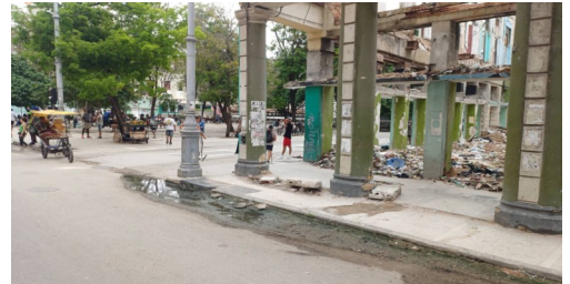
Esquina derruida de las calles San Rafael y Galiano. Foto: ICLEP
