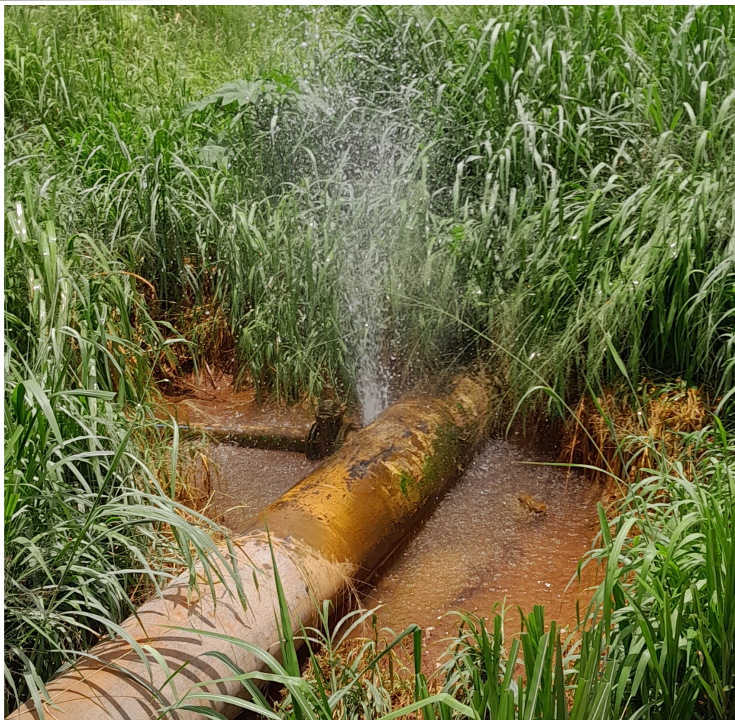
Tubería de agua rota en la calle 50. Foto: ICLEP
