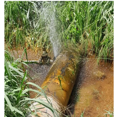
Tubería del pozo Waterloo, calle 50, municipio Artemisa. Foto: ICLEP
