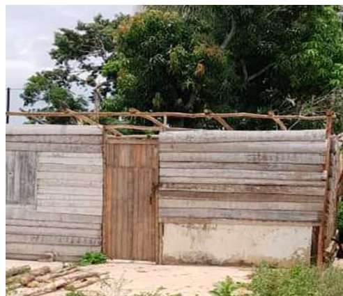
Vivienda sin techo en el poblado Lincoln, municipio Artemisa. Foto: ICLEP
