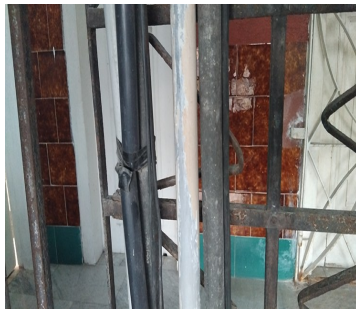
Detalle del empate de los cables a causa del robo, Centro Habana. Foto: ICLEP
