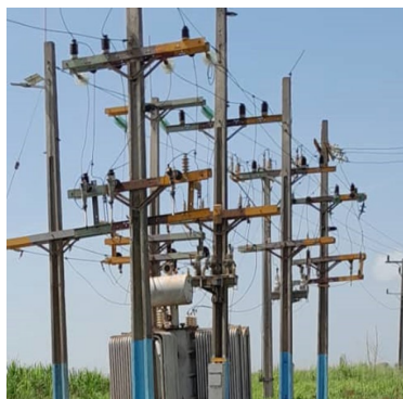
Subestación eléctrica. Foto: ICLEP
