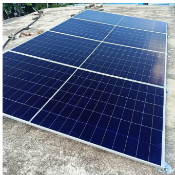
Paneles solares. Foto ICLEP
