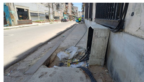
Registro eléctrico soterrado en Centro Habana. Foto: ICLEP
