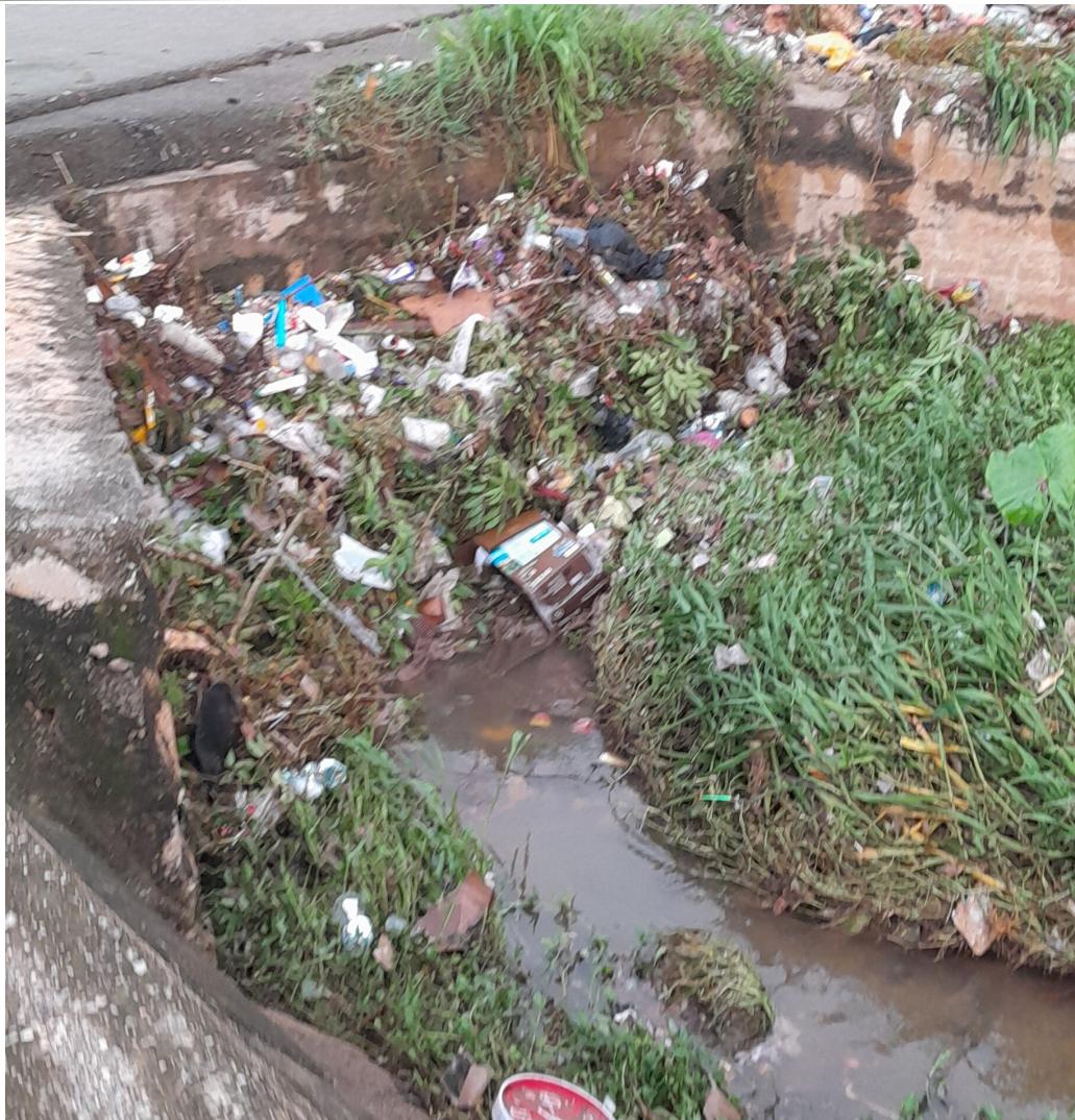
Canal de desagüe de la calle Masó, Artemisa. Foto: ICLEP
