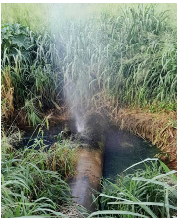
Tubería principal del pozo Waterloo. Foto: ICLEP
