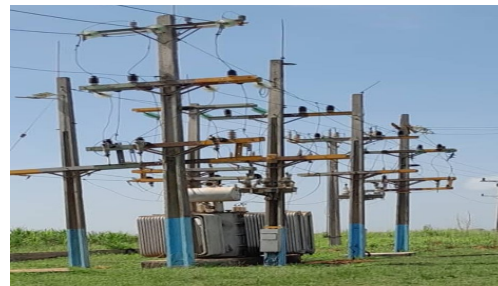
Torre del Sistema Eléctrico. Foto: ICLEP
