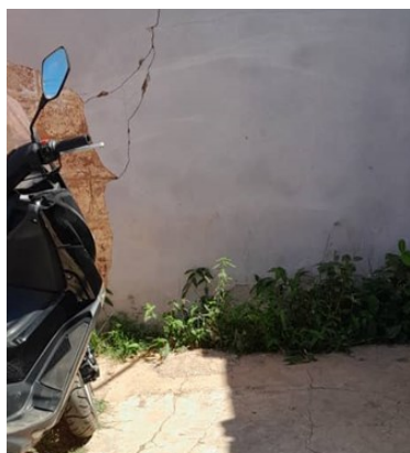
Muro en la oficina de Fincimex, municipio Artemisa. Foto: ICLEP
