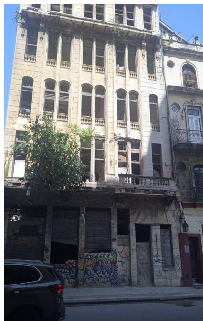
Edificio en peligro de derrumbe en Monserrate número 359. Foto: ICLEP
