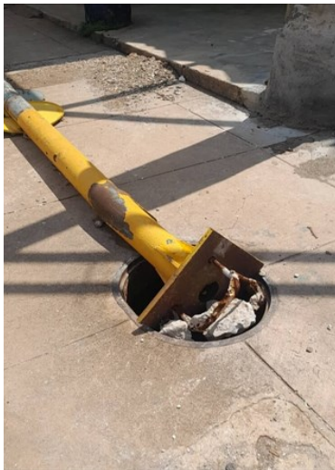
Poste eléctrico derribado en la calle Central, municipio de Artemisa. Foto: ICLEP
