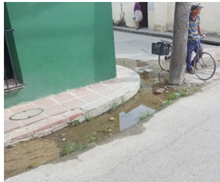
Fosa drenando a la calle. Foto de ICLEP
